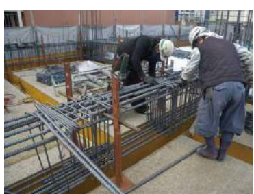
10月 地上躯体工事に着手し鉄筋工事の業者さんたちによる梁のセッティング状況です。
