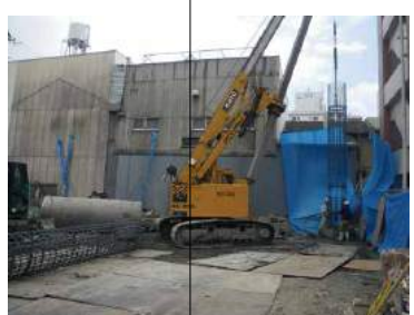
9月 隣家に近いところの杭工事が、大変でした。写真では杭鉄筋を慎重に建てこんでいるのが分かります。
